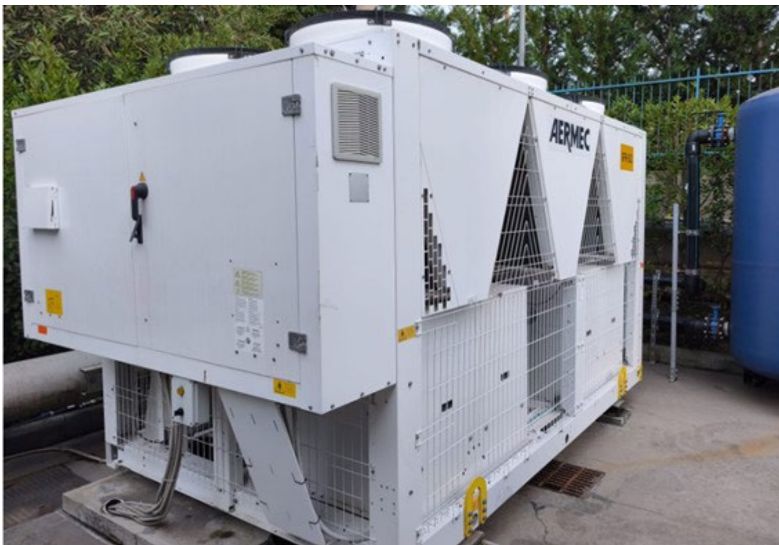
Foto: Impianto di refrigerazione
