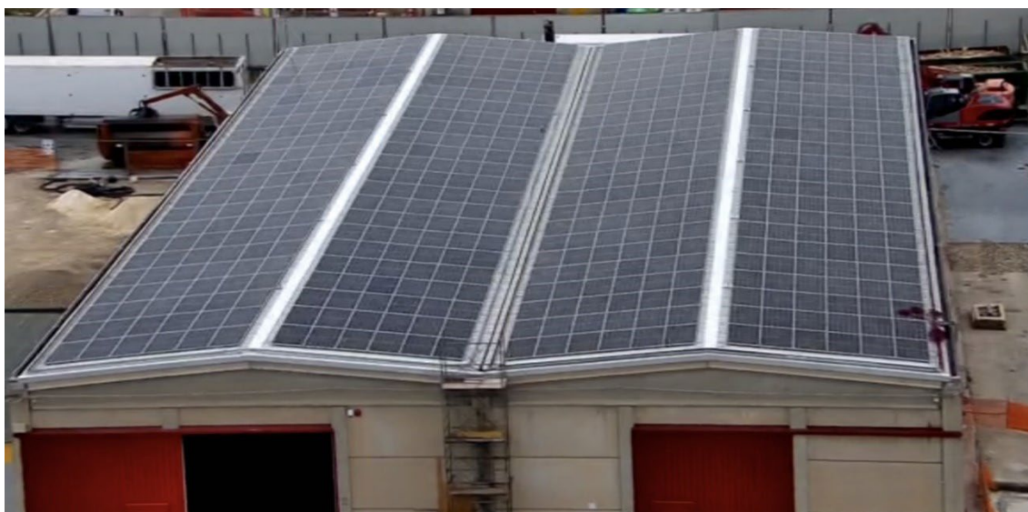
Foto: Vista dall'alto dell'impianto fotovoltaico su tetto
